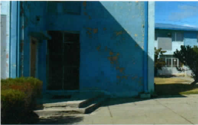
Fotografía N° 15: Plataformas y gradas prefabricadas de accesos; limpiapiés, sin ejecutar. Casino 1
