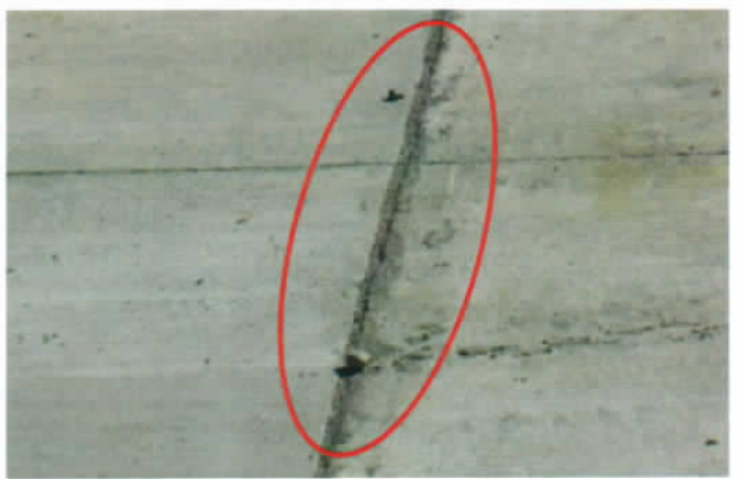
Fotografía N° 6: Irregularidad superficial en las juntas de trabajo del pavimento de hormigón de la calzada de calle Eduardo Simián.
