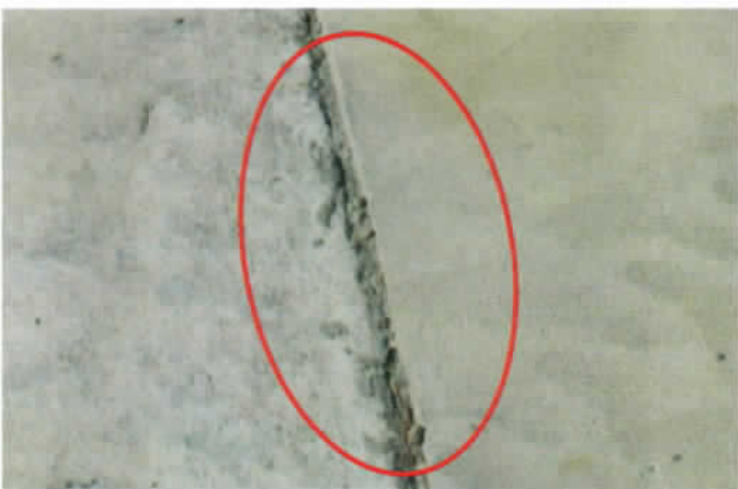
Fotografía N° 5: Irregularidad superficial en las juntas de trabajo del pavimento de hormigón de la calzada de calle Eduardo Simián.
