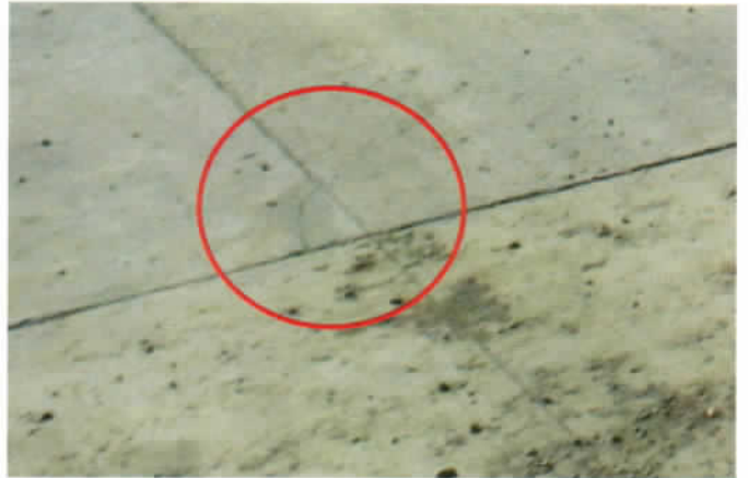
Fotografía N° 2: Fisura en el pavimento de la calzada, esquina del paño de la segunda franja poniente.
