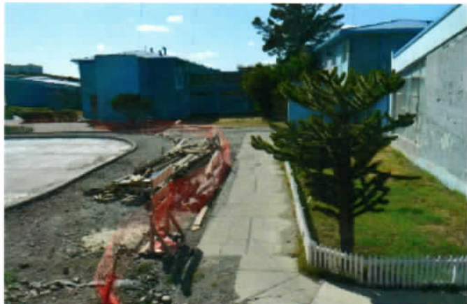
Fotografía N° 1: Pavimentos de hormigón (aceras) no demolidos, sector casino 2.
