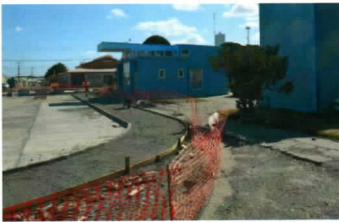
Fotografía N° 6: Pavimento Aceras HCV liso normal, sin ejecutar. Sector estacionamientos.
