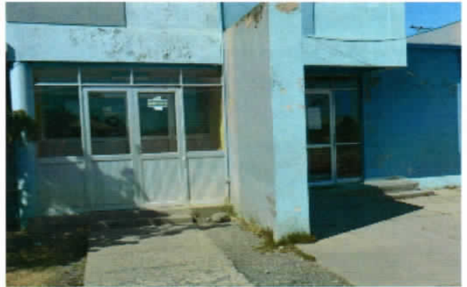
Fotografía N° 16: Plataformas y gradas prefabricadas de accesos; limpiapiés, sin ejecutar. Casino 2
