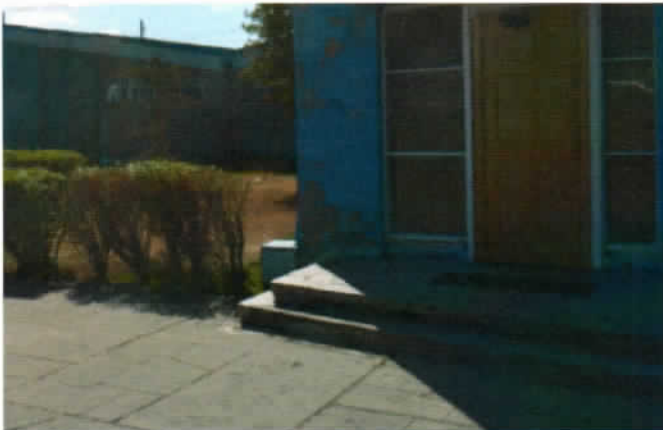
Fotografía N° 9: Pavimento rampa para minusválidos sin ejecutar. Casino 1.
