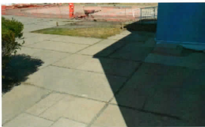
Fotografía N° 11: Pavimento pastelones de hormigón estampado, sin ejecutar.
