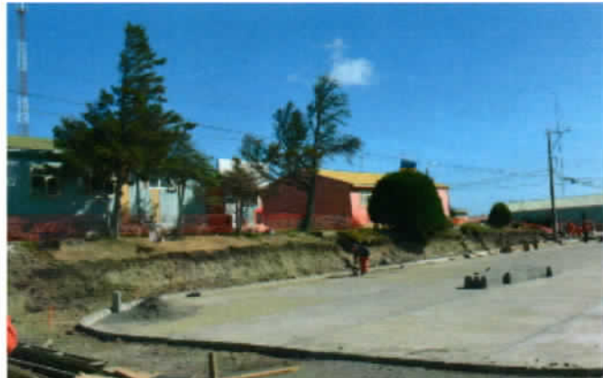
Fotografía N° 20: Escaleras y barandas acera poniente, sin ejecutar.
