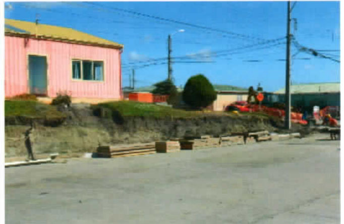
Fotografía N° 18: Escaleras y barandas acera poniente, sin ejecutar.
