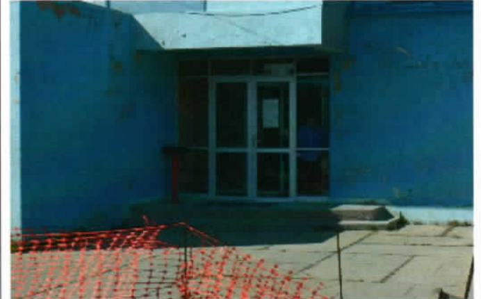
Fotografía N° 10: Pavimento rampa para minusválidos sin ejecutar. Casino2.
