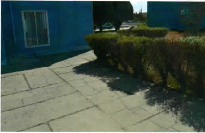
Fotografía N° 13: Pavimento pastelones de hormigón estampado, sin ejecutar.
