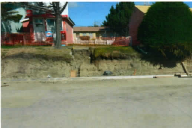
Fotografía N° 17: Escaleras y barandas acera poniente, sin ejecutar.
