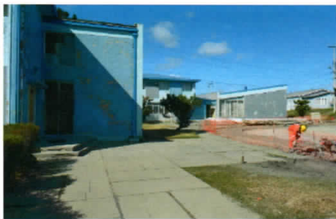
Fotografía N° 2: Pavimentos de hormigón (aceras) no demolidos, sector casino 1.
