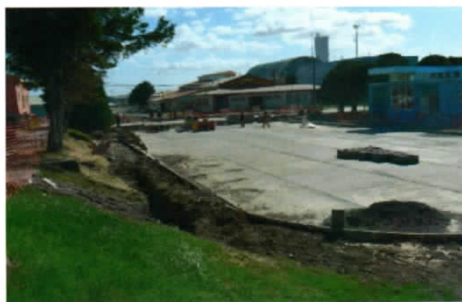
Fotografía N° 5: Pavimento Aceras HCV liso normal, sin ejecutar. Sector estacionamientos.
