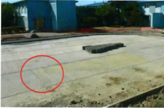
Fotografía N° 1: Fisura en el pavimento de la calzada, paño de la segunda franja poniente.
